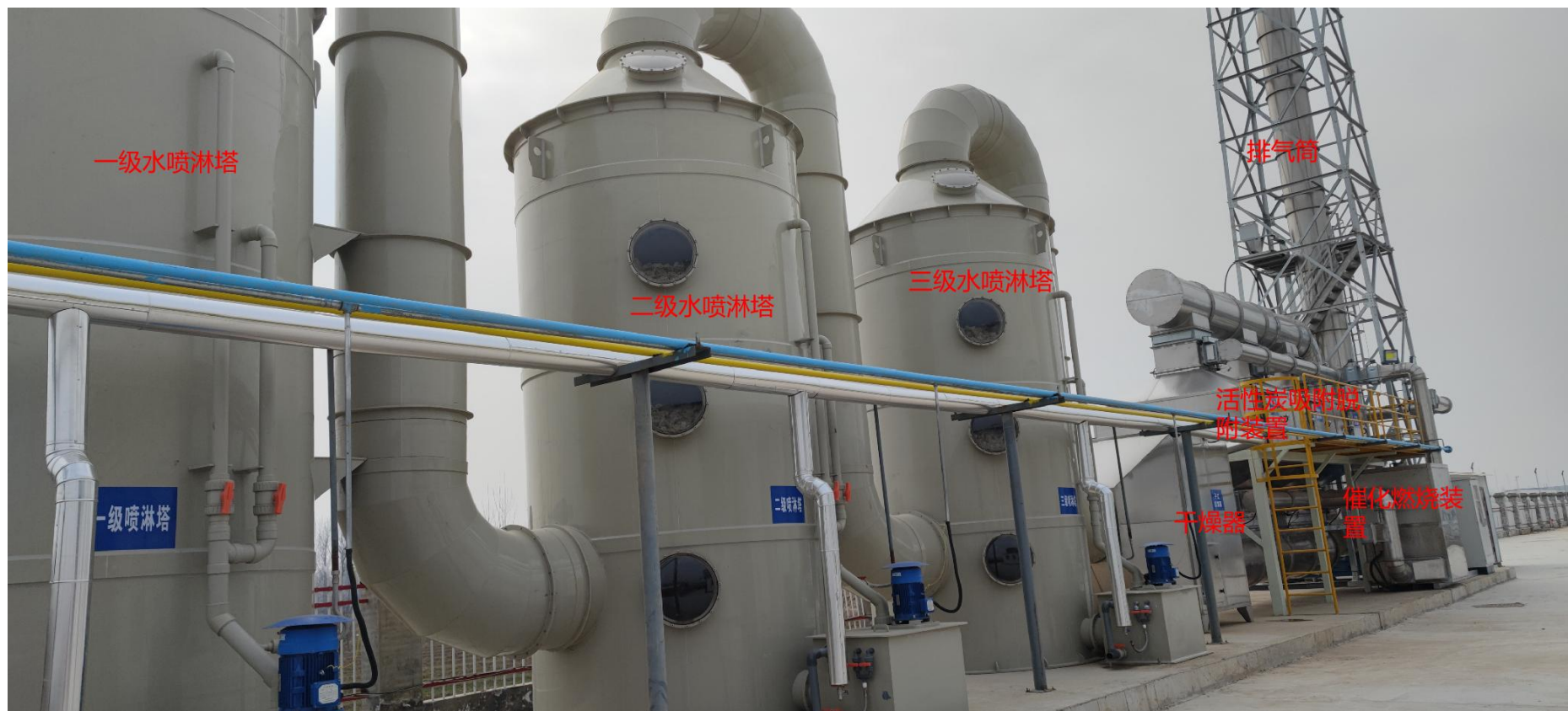
附图8 废气处理设施设施（1#排气筒）
